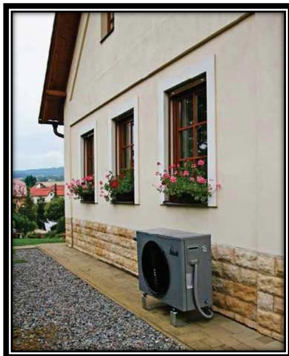
Obr. 1: Tepelné čerpadlo vedle domu Zdroj: Autor
