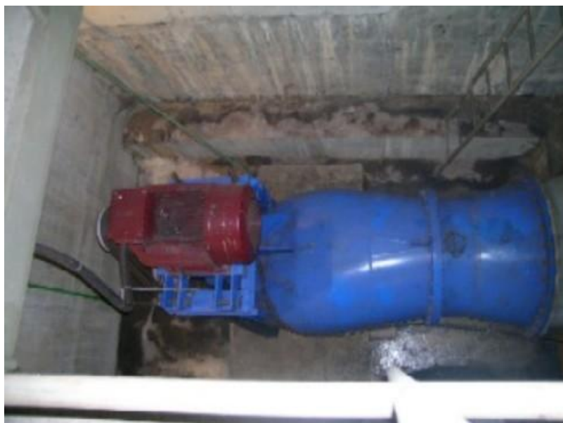
Obr. 11: Strojovna MVE - pohled na turbínu a generátor
