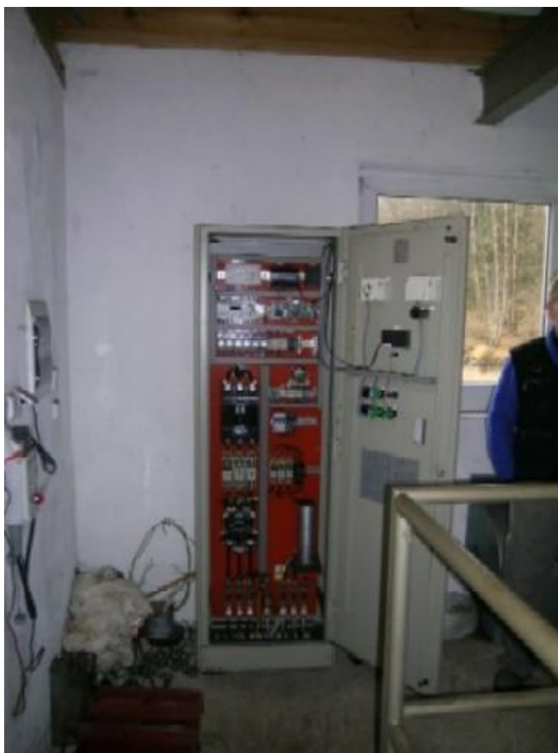
Obr. 10: Strojovna MVE - pohled na rozvaděč
