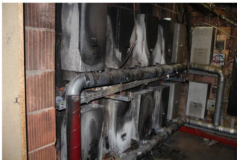
Obr. 4: Požár v instalační místnosti FV systému
