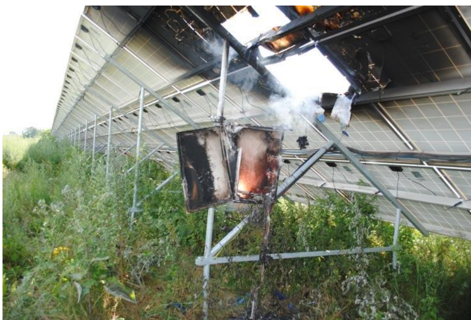
Obr. 1: Ukázka požáru fotovoltaiky
