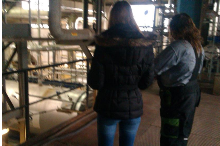
Obr. 15: Pohled na záložní plynové kotle Foto: Autor
