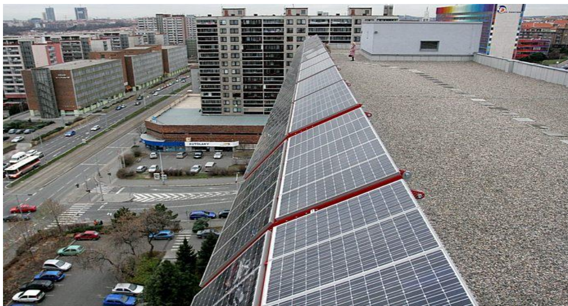
Obrázek 3- Solární elektrárna Ministerstva životního prostředí
