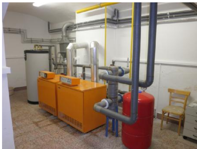
Obr. 8: Původní plynové kotle [8]
