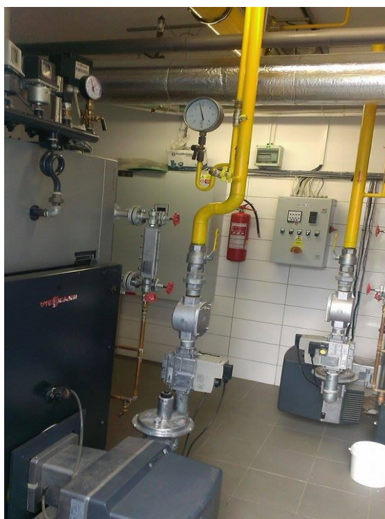
Obr. 2: Nová kotelna s plynovými parními kotli [6]
