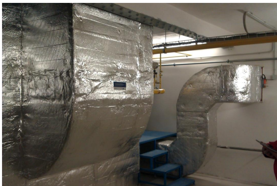
Obr. 18: Izolované vzduchovody na hvozdu
