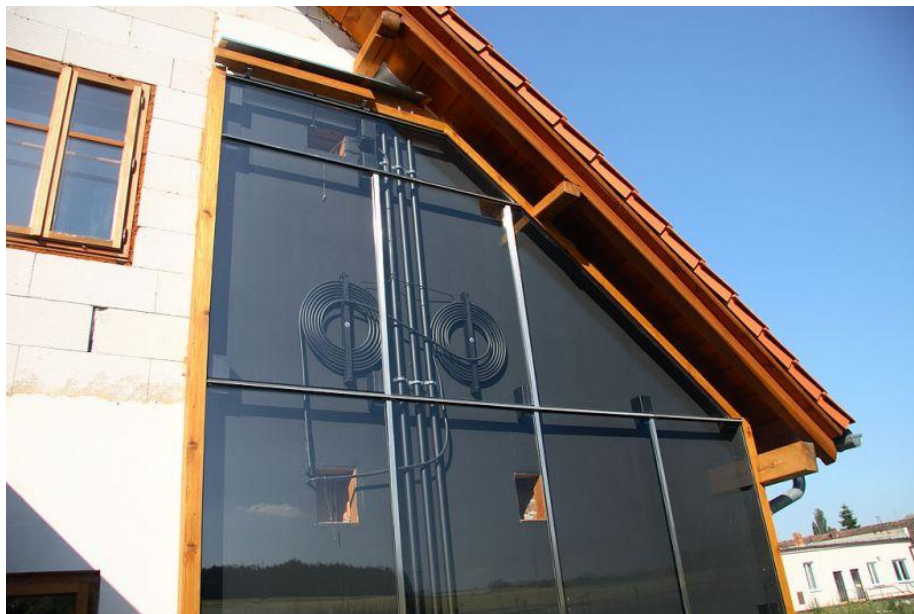
Zařízení na ohřev vody
